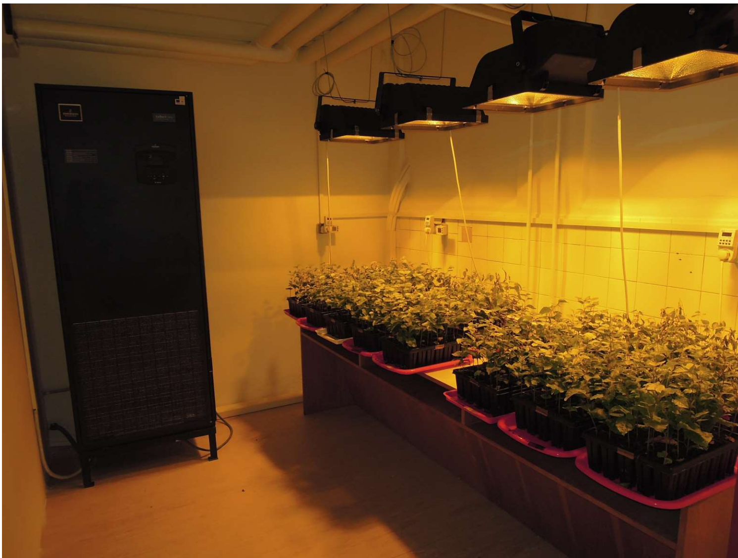
Miestnosť s umelým zdrojom žiarenia a klimatizačnou jednotkou
