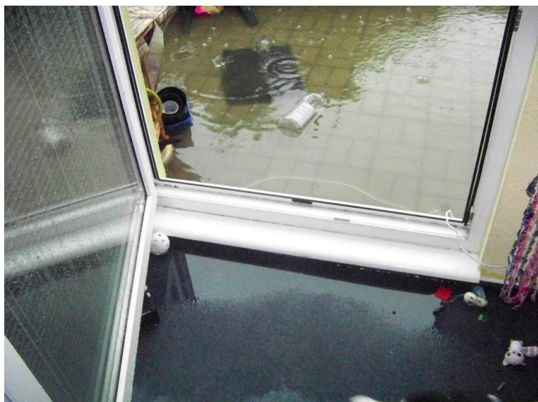
Obrázek 2 Nedostatečná kapacita jímky při přívalovém dešti
