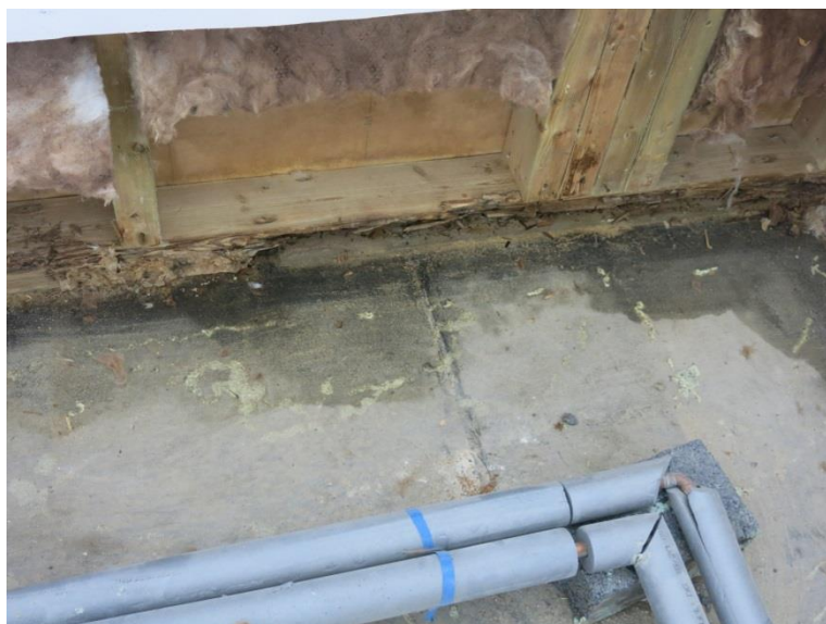
Obrázek 3 Degradace nosných prvků konstrukce
