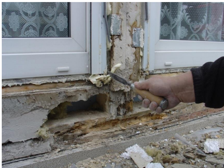
Obrázek 1 Zatékání do fasády hnaným deštěm na podbití střechy
